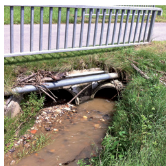
Hundsdorfbach-Durchfluss: Wer ist für die Räumung zuständig?
