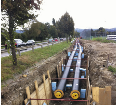
Fernwärme-Rohrleitung, die 20.000 Tonnen CO 2 sparen hilft
